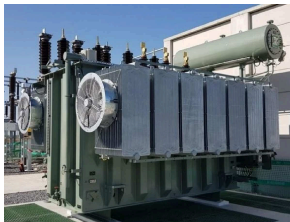
Radiadores num transformador
